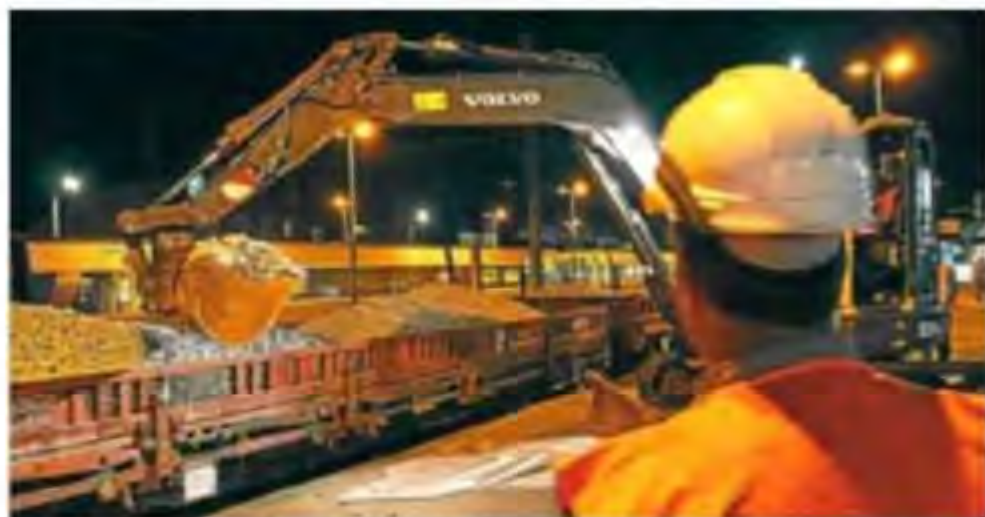
Avant le début des travaux du Pem, SNCF Réseau a lancé des travaux ferroviaires en gare d'Auray. (Photo d'archives Le Télégramme)
