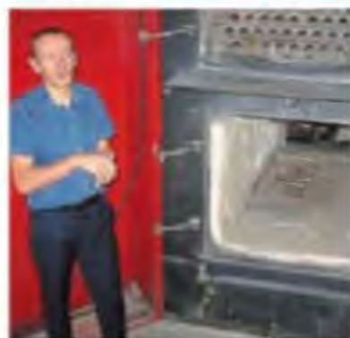
Nicolas Foll, du fonctionnement de la chaudière bois, a donné des explications.
